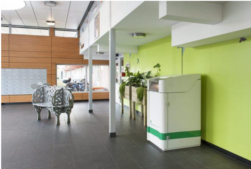
Een speciale GFE container.
